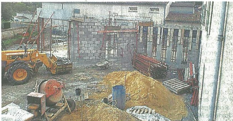
Les travaux de la mairie, derrière l'actuel bâtiment, avancent à grands pas.
