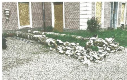
Les ouvriers ont déblayé le monument de ses pierres, dont celles qui constituaient une des cheminées du château.
