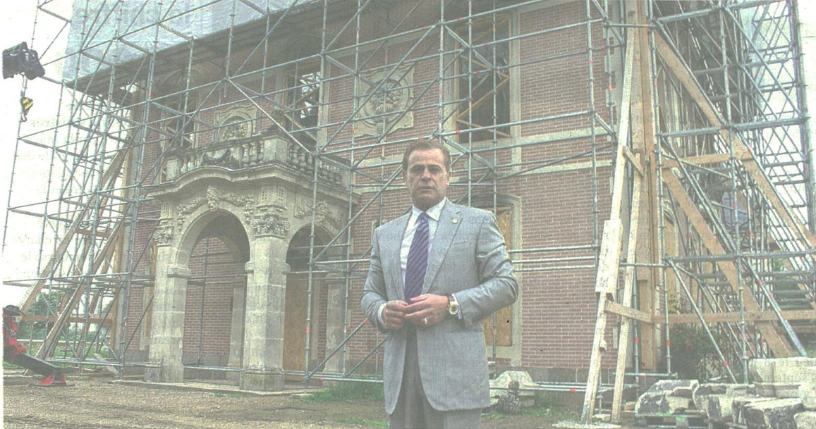
Trois mois après l'incendie du château du Petit-Chêne, son propriétaire attend le retour des assurances pour poursuivre les travaux. (Photo NR)
